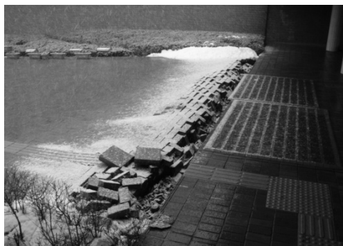
図2 大崎生涯学習センターの建物周辺の被害状況。外構が大きく破損した様子。（写真提供：遊佐徹氏）
