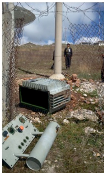
図7 2012年4月26日、変圧器が盗まれた後
